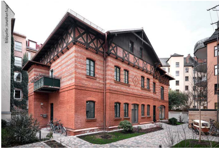
Abb. 2: Neben einer Vielzahl von Sanierungsmaßnahmen erhielt die Sichtziegelfassade ihre verdiente Aufmerksamkeit und ist heute der Blickfang im idyllischen Hinterhof.
