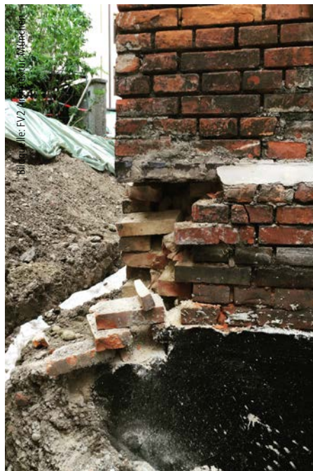
Abb. 9: Im freigelegten Zustand wurden die Blindziegel begutachtet und Beschädigungen aufgenommen.
