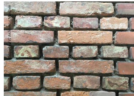
Abb. 5: Bei der Sichtziegelfassade im Bereich des Erdgeschosses wurde beim Bau an allen Fassaden auf den Fugenmörtel verzichtet, das Mauerwerk blieb bis zur Sanierung bis auf den Setzmörtel einsehbar.
