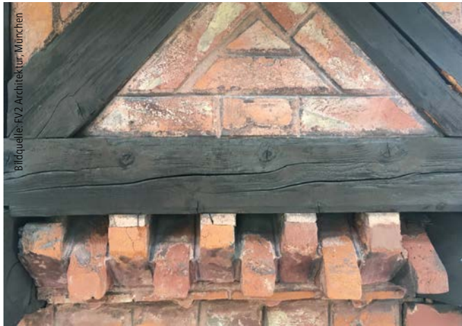
Abb. 10: Für Sondersituationen wie ein Gefach in den Andreaskreuzen des Fachwerknienstocks wurden in Handarbeit neue Formsteine wie Puzzelstücke zusammengefügt.
